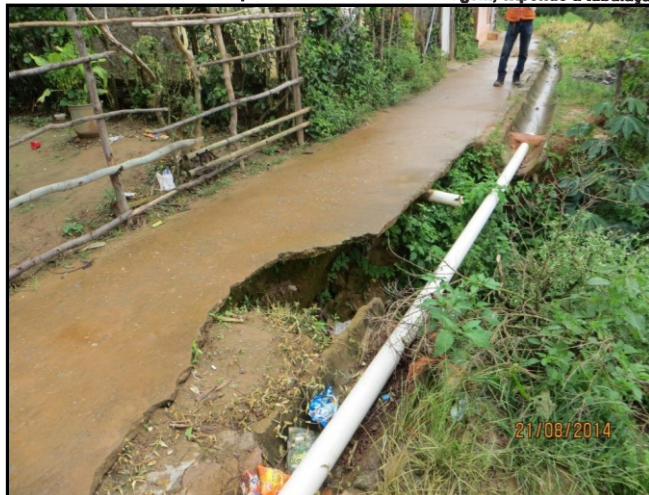
Onde houve a ruptura das canaletas, as águas infiltradas induziram erosão localizada.
